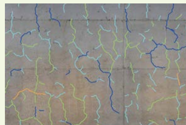
AIによるひび割れ検知
